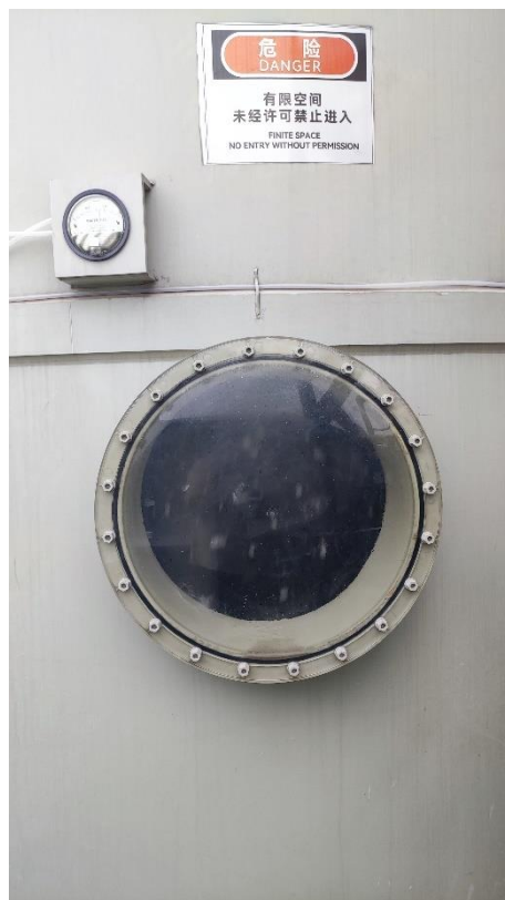
喷淋塔(排气筒 DA004)
