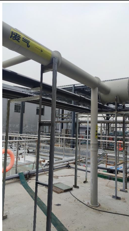
污水处理站密闭收集措施
