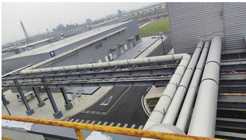
105 化学品库 1 储罐呼吸气收集管道
