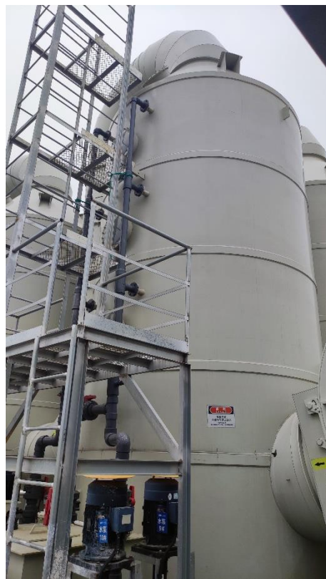
喷淋塔(DA001 排气筒)
